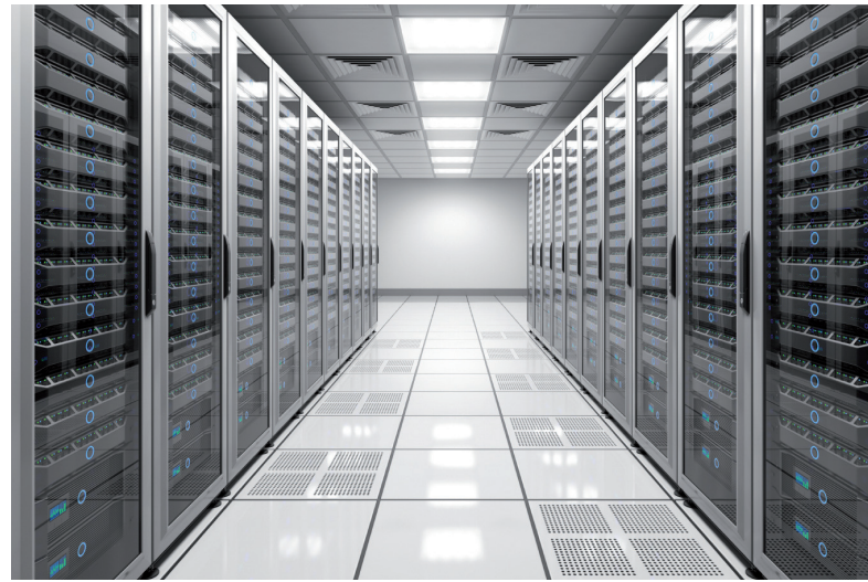
Beispiel eines Serverraumes
